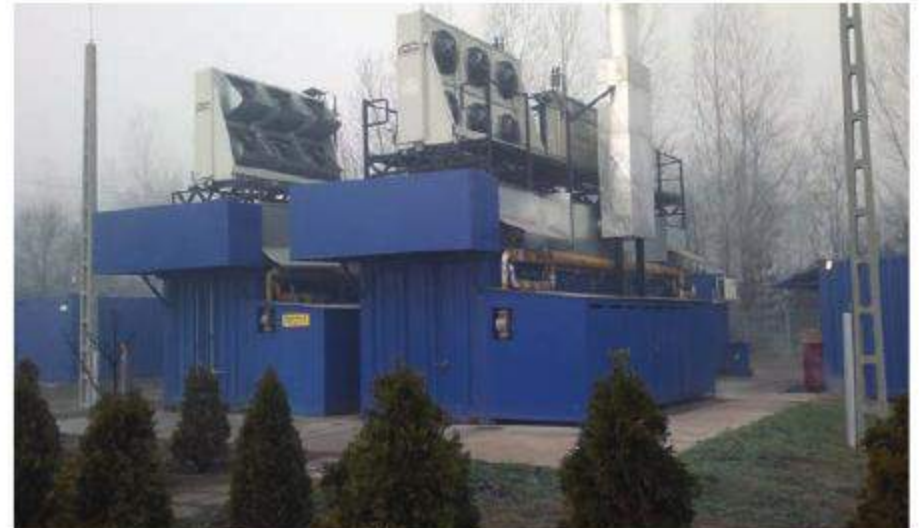
Depónia-gáz alapon működő blokkerőmű (Gyál)
