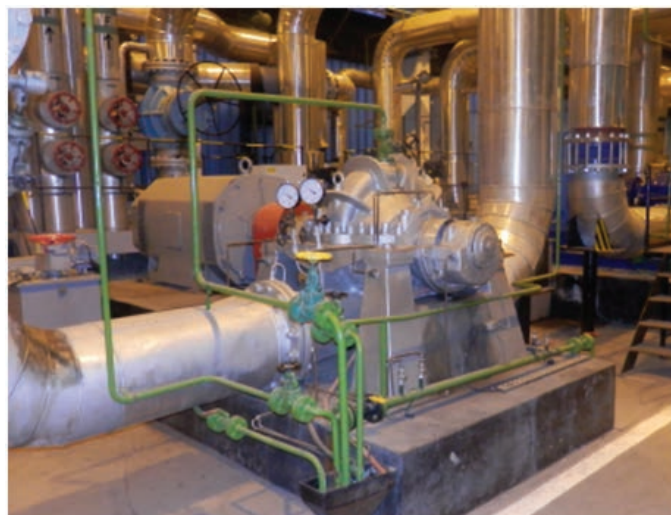
2. kép. Füredi Fűtőmű régi keringtető szivattyú
