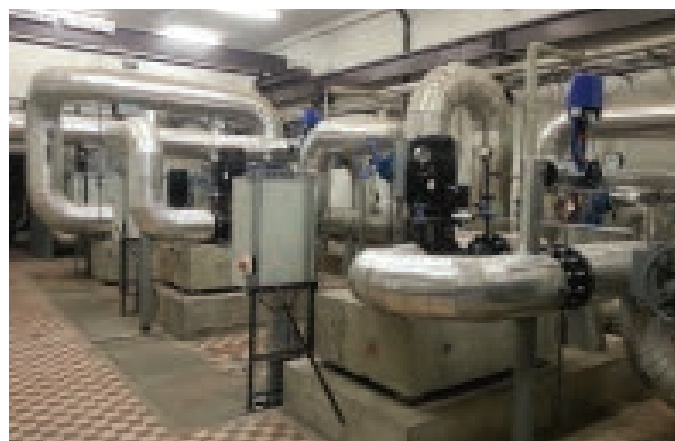
4. kép. Szurdok utca új szivattyúi
