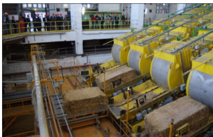
14. ábra Pécsi fűtőerőmű biomassza blokkja II.
