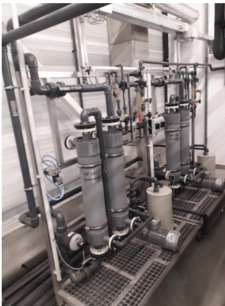
8. kép. A megvalósult membránkontaktoros gáztalanító berendezés
