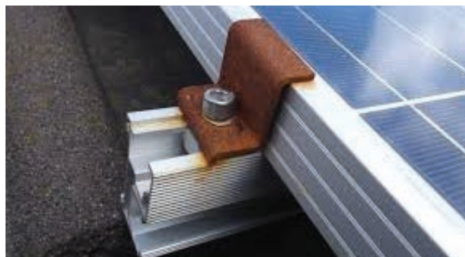
5. kép. A hibás rögzítésből kiinduló szél által okozott károsodás
