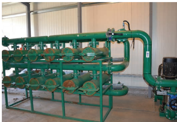
7. kép. A lehűlt termálvizet szűrőkön keresztül szivattyúk nyomják a visszasajtoló kútba
