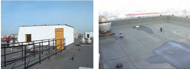
A lapos tető állapota a felújítás előtt
