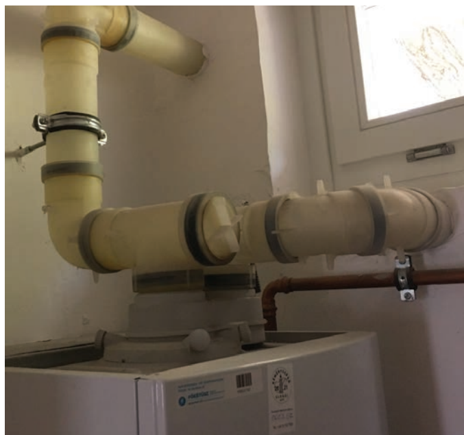
3. fénykép. Az égési levegő és a füstgáz csövei
