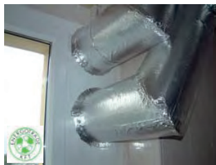
A légtéchnikai csővezetékek ablakkereten való kivezetése (burkolat nélkül)
