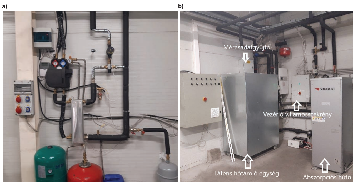
3. ábra. Az üzemcsarnok első emeletén található gépészeti tér a szolár állomással, lemezes hőcserélővel (a); vezérlő és mérésadatgyűjtő villamos szekrény, hidegenergia akkumulátor, abszorpciós hűtőgép (b)
